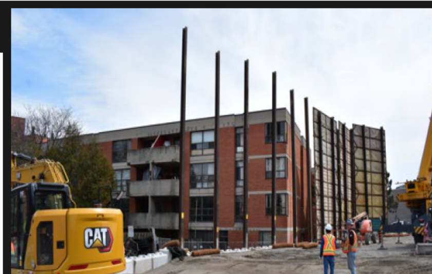
Réduction du bruit et de la vibration : Prolongement du métro vers Scarborough Murs bruyants
