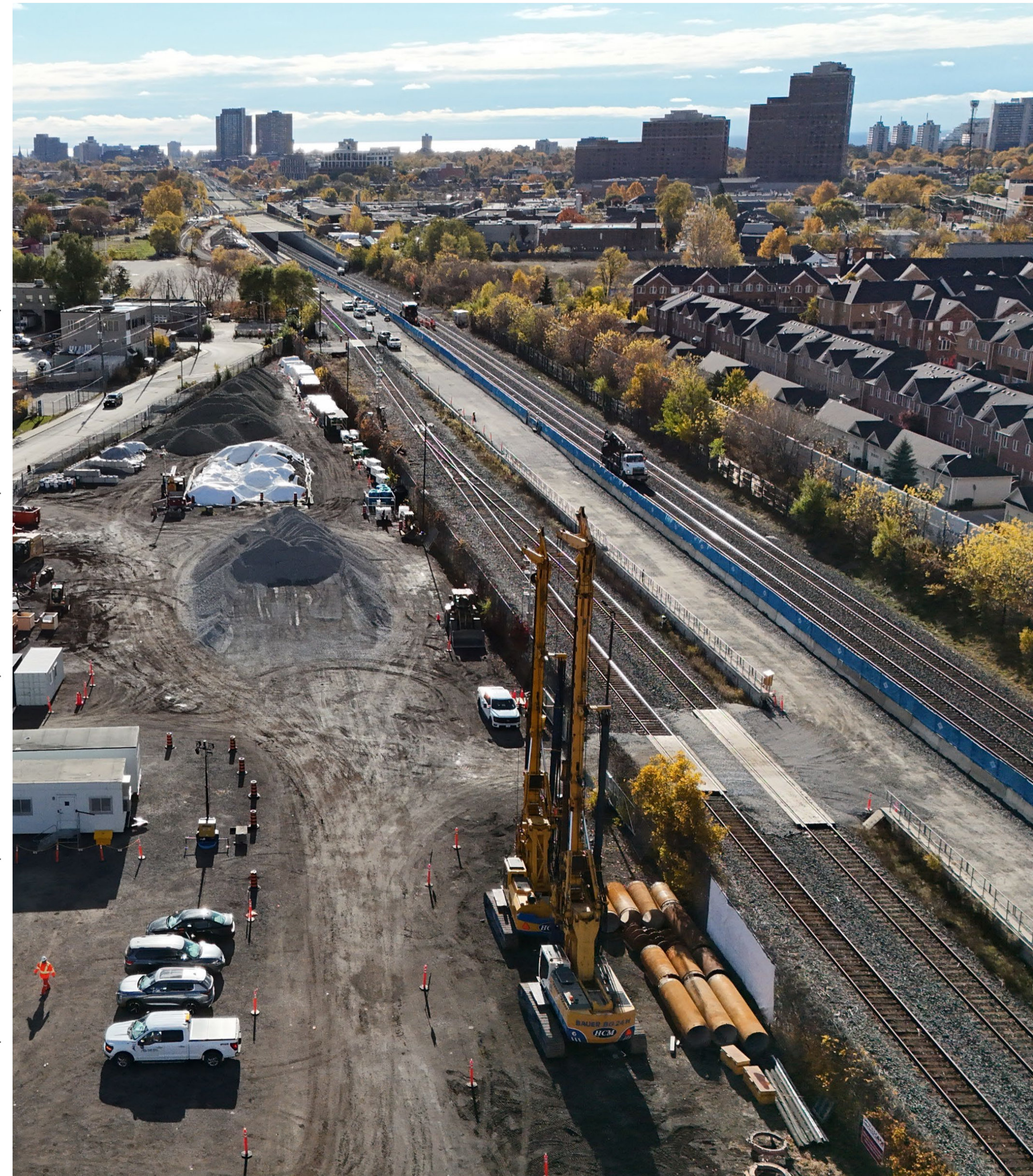
Site de la future gare avec la zone de travaux continus élargie.
