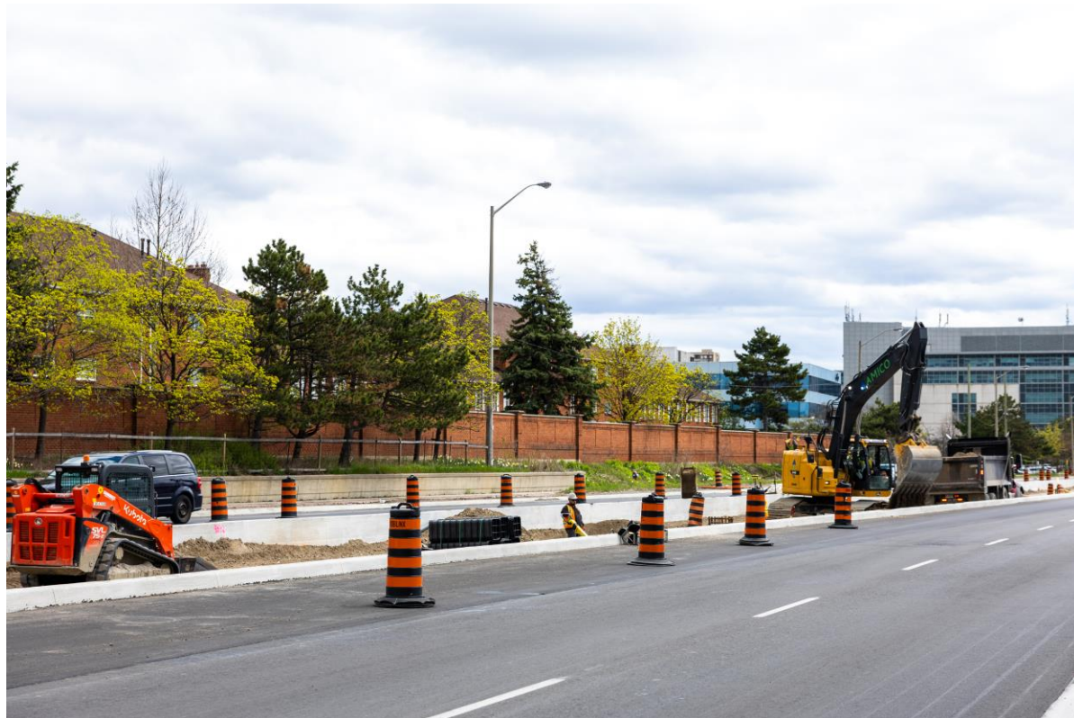
Travaux sur la voie centrale de la rue Hurontario au sud de la voie Lancashire
