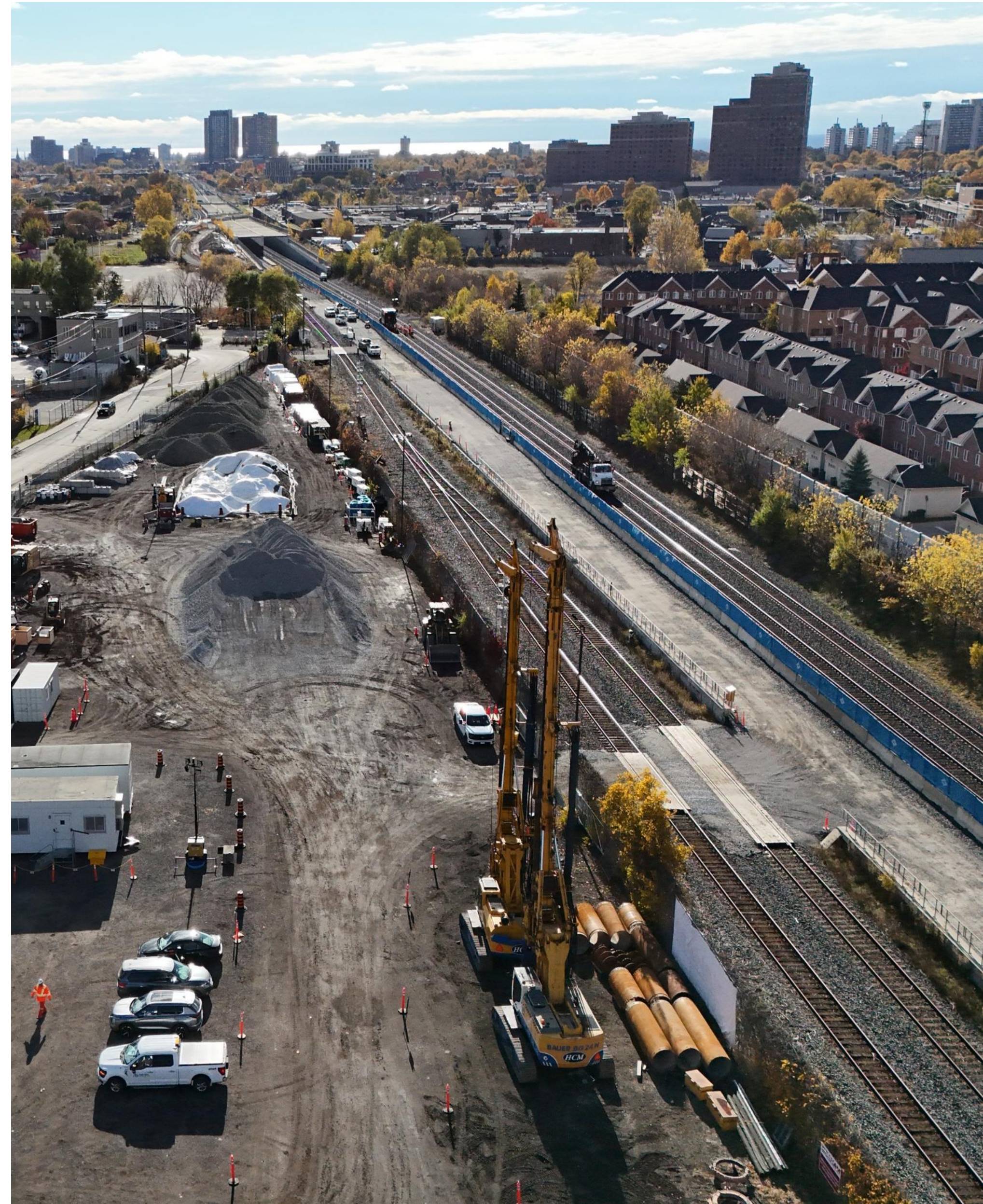
Site de la future gare avec la zone de travaux continus élargie.
