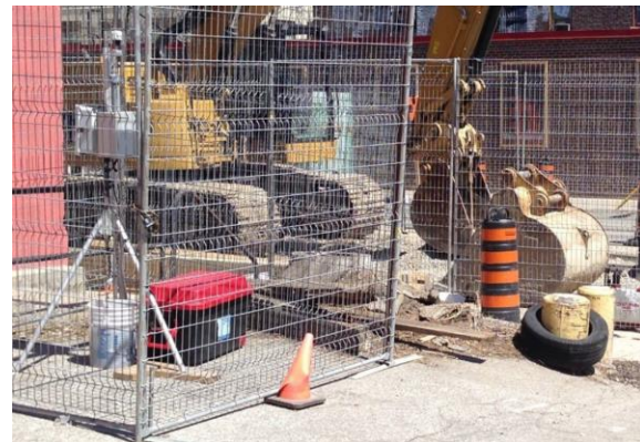
Exemple de capteur de poussière de construction dans une enceinte clôturée (côté gauche de la photo)
