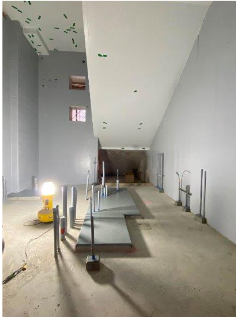
Salle électrique 3, août 2026
